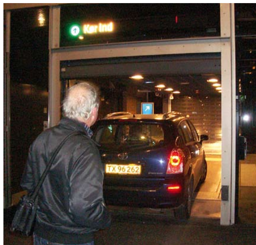
Bilen på vej ind i elevatoren for at blive ført ned i kælderparkeringen.
