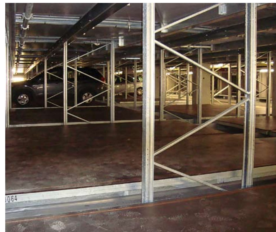
En af parkeringsetagerne under jorden, hvor bilerne automatisk føres på plads.
