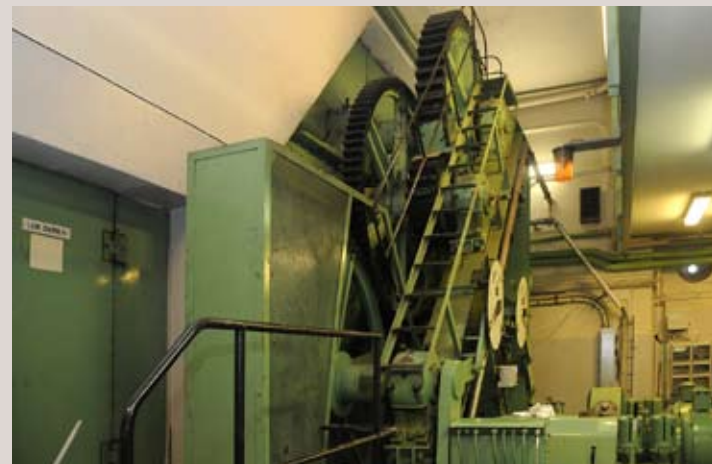
De store tandhjul, der er med at drive klappen og baskuleringen.
