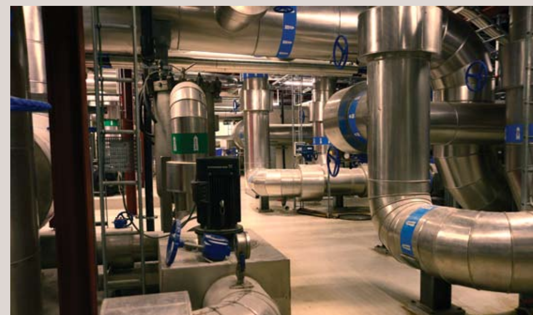
Fjernkølingsnettet kræver store underjordiske tunneler, som er blevet etableret uden de store gener for Københavns trafik
