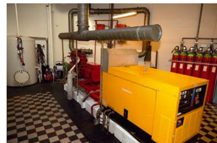
Nederst i fyret er maskinrummet med dieselmaskiner og generatorer.
