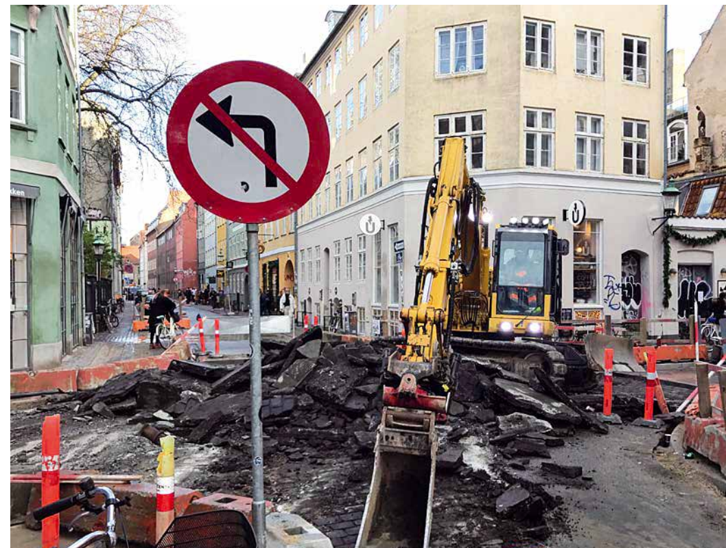
Arbejdet har efter sigende medført revner i bygninger, men kommunen dækker sig ind forvaltningsretligt.
